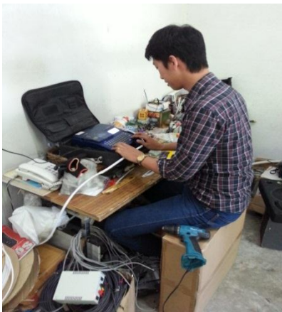
รูปที่ 3 มาร์คสายไฟที่จะใช้ในระบบ
