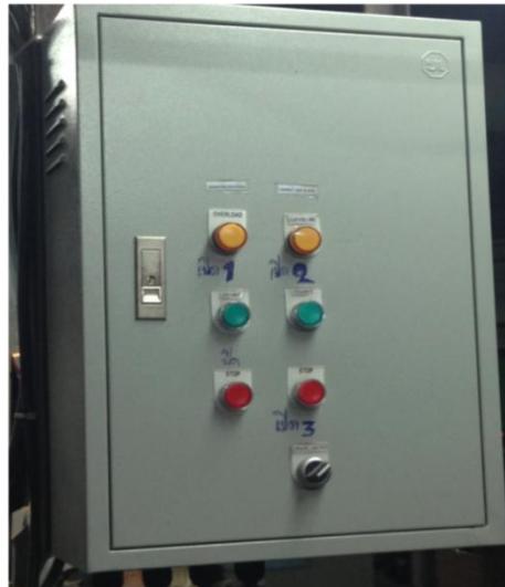
รูปที่ 2 ตู้ที่ใช้ติดตั้งอินเวอร์เตอร์
