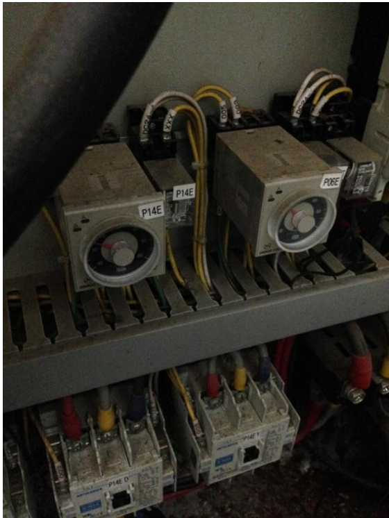
รูปที่ 9 การติดตั้งไทม์เมอร์
