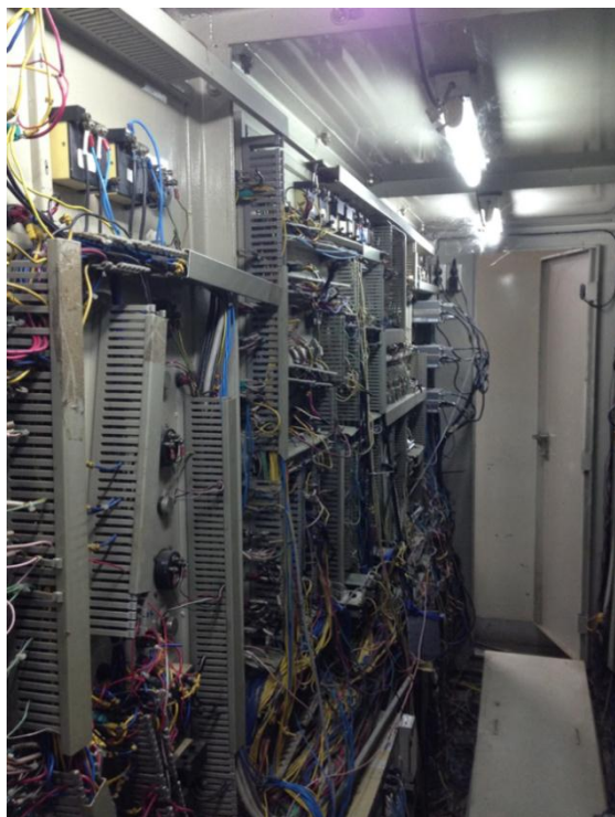
รูปที่ 10 ภายในตู้ควบคุมหลัก
